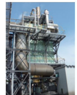
熱風炉の排ガス処理設備
