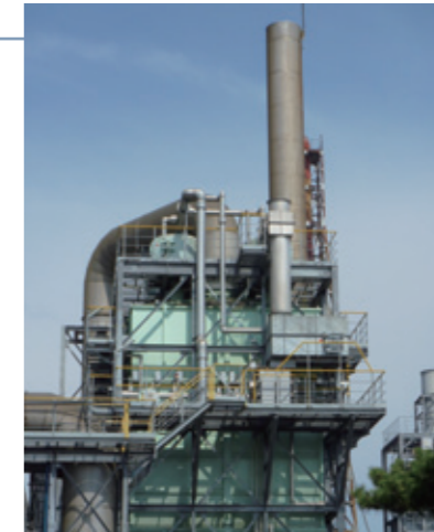
スラグフューミング炉の排ガス処理設備
