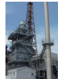
発電所の排ガス処理設備
